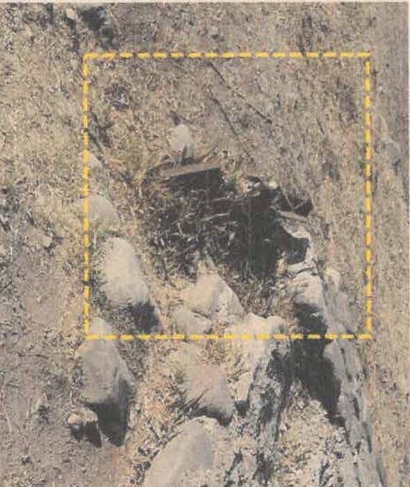
Remover elementos metálicos en mal estado
