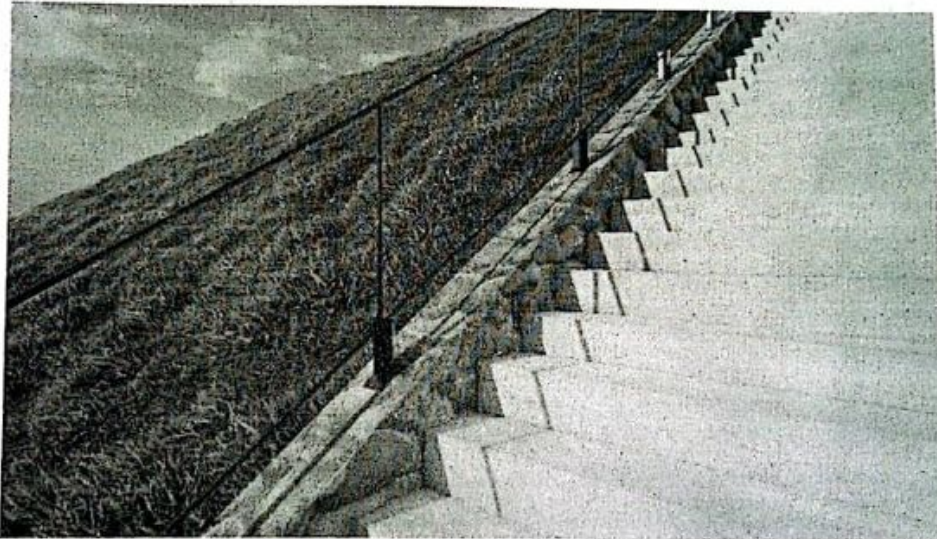
Imagen ilustrativa de sector de baranda nueva construir y colocar. Los detalles de baranda se encuentran en los planos correspondientes.
